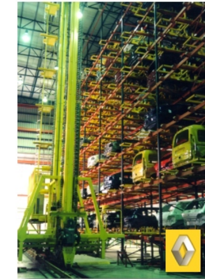
Almacén Automático de carrocería pintadas
